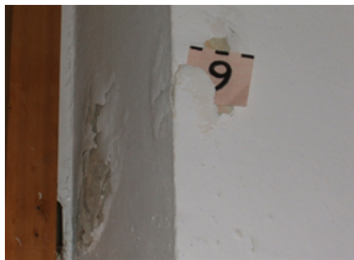
Fig. 2 Expansiunea sarurilor sub finisaje
